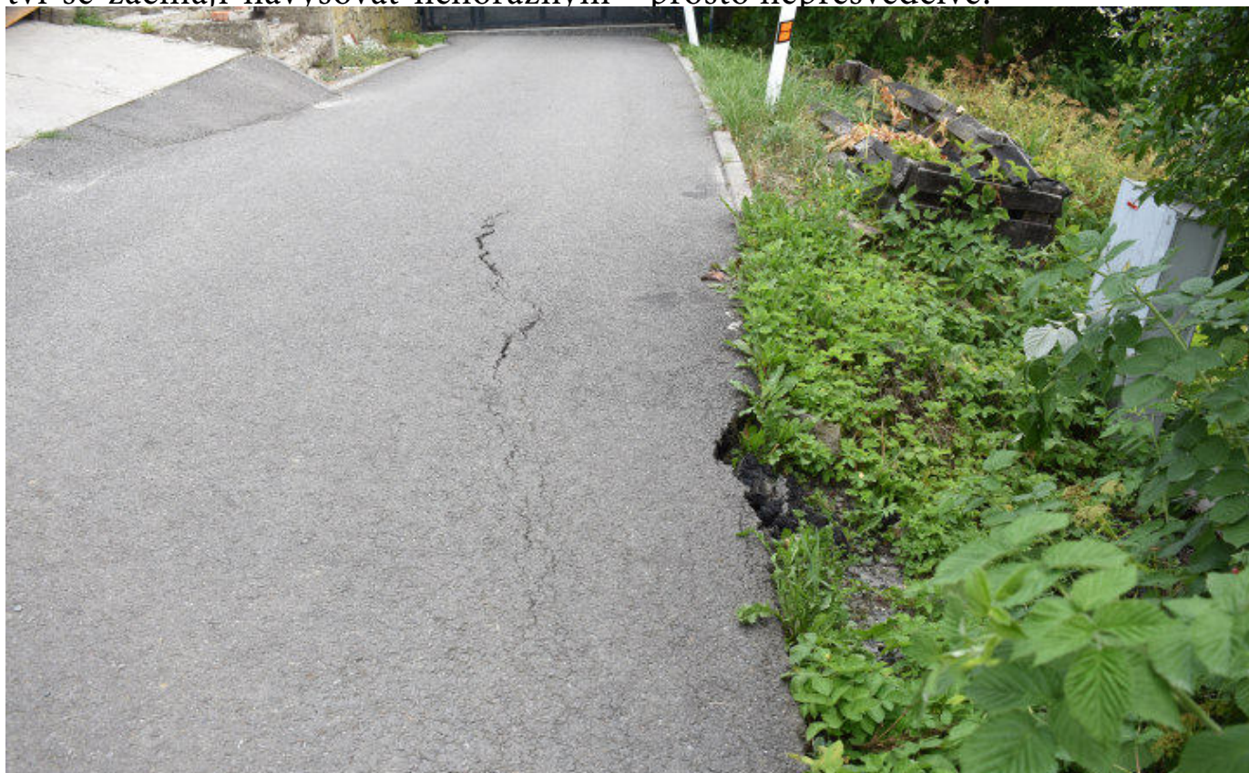
Komunikace na kopci bude brzy vyžadovat stavební zásah
